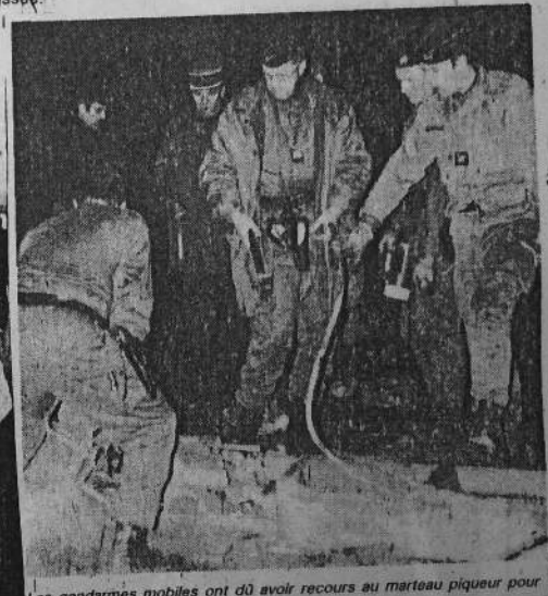
Les gendarmes mobiles ont dû avoir recours au marteau piqueur pour débiter les deux poteaux électriques.
