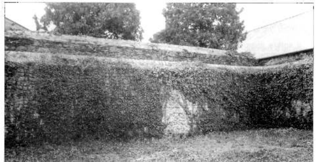
Une architecture dissuasive : les murs du chemin de ronde. Si quelque détenu réussit à escalader le mur intérieur, il lui restera à franchir le mur extérieur, encore plus haut que le premier, et bien visible de toutes les cours.
