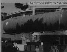
La citerne installée au Moustoir.
