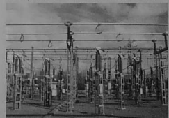
Le poste électrique de Belle Epine, à Vézin-le-Coqueit, permet la distribution du courant.
