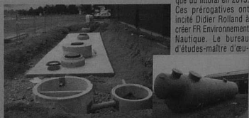
La cuve est enterrée à Paimpol (photo) comme au Légué.
