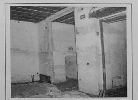
Centrale électrique Au 1 er plan socle des groupes électrogènes A droite : au fond local du refroidisseur en avant local du transformateur
