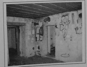
Local de troupe : conduites de ventilation visibles près du plafond
