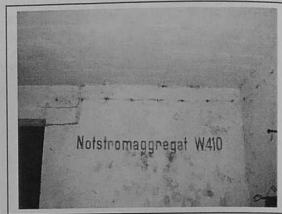
Notstromaggregat W410 = groupe électrogène de secours du point d'appui codé W 410
