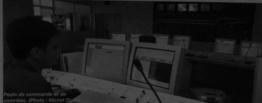
Poste de commande et de contrôles. (Photo : Michel Oger)
