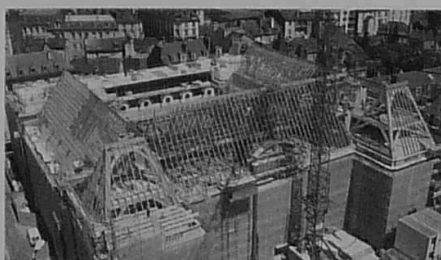
Photo de W. Berré © Le Parlement de Bretagne en juin 1997 - charpentes en bois des pavillons Sud réalisées : mise en œuvre des chevrons et du voligeage.
