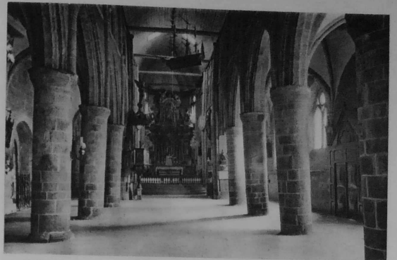
BRÉLÈVEZ. — Eglise. — Intérieur. Piliers et arcades du xii e s. ; par suite de l'affaissement de la voûte, les piliers se sont infléchis en dedans. Voûtes en bois. Un petit navire y est suspendu en ex-voto.
