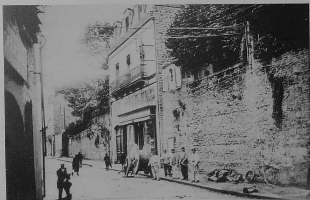
Le déroulement des câbles téléphoniques rue de Verdun en 1922-23. (Coll. Archives Municipales).
