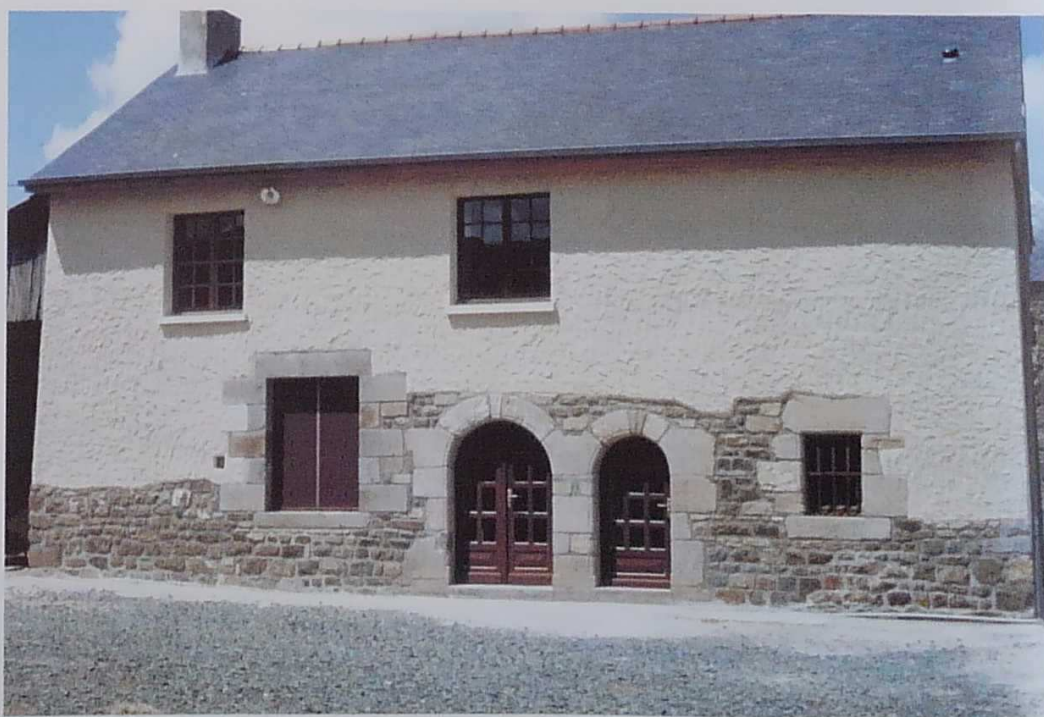
Réhabilitation agressive des années 1980 portant atteinte aux structures et aux matériaux d'origine (Ille-et-Vilaine).
