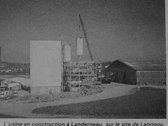
L'usine en construction à Landerneau, sur le site de Lanniron, d'où sera exportée une partie de la production.
