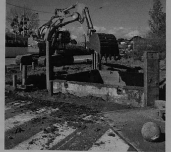
Fin de travaux du poste de relèvement des eaux usées du vélodrome.
