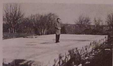
Le bassin achevé, prêt à recevoir les équipements futurs (pompes à chaleur, pompes de reprise, installations électriques, etc.)
