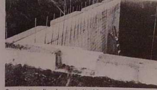
Construction d'un bassin isolé 116 cm de polystyrène pour le stockage de l'eau chaude (qui sera produite principalement pendant les heures creuses)
