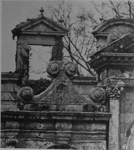
Détail de l'aile effondrée.
