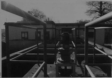
USINE DES EAUX DU BIZIEN À L'ARRET
