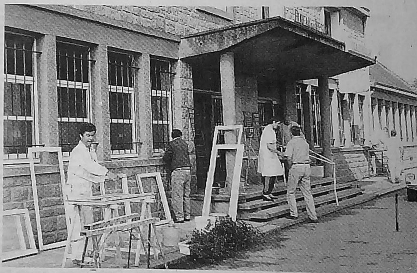
Toutes les vitres du bâtiment ont volé en éclats.
