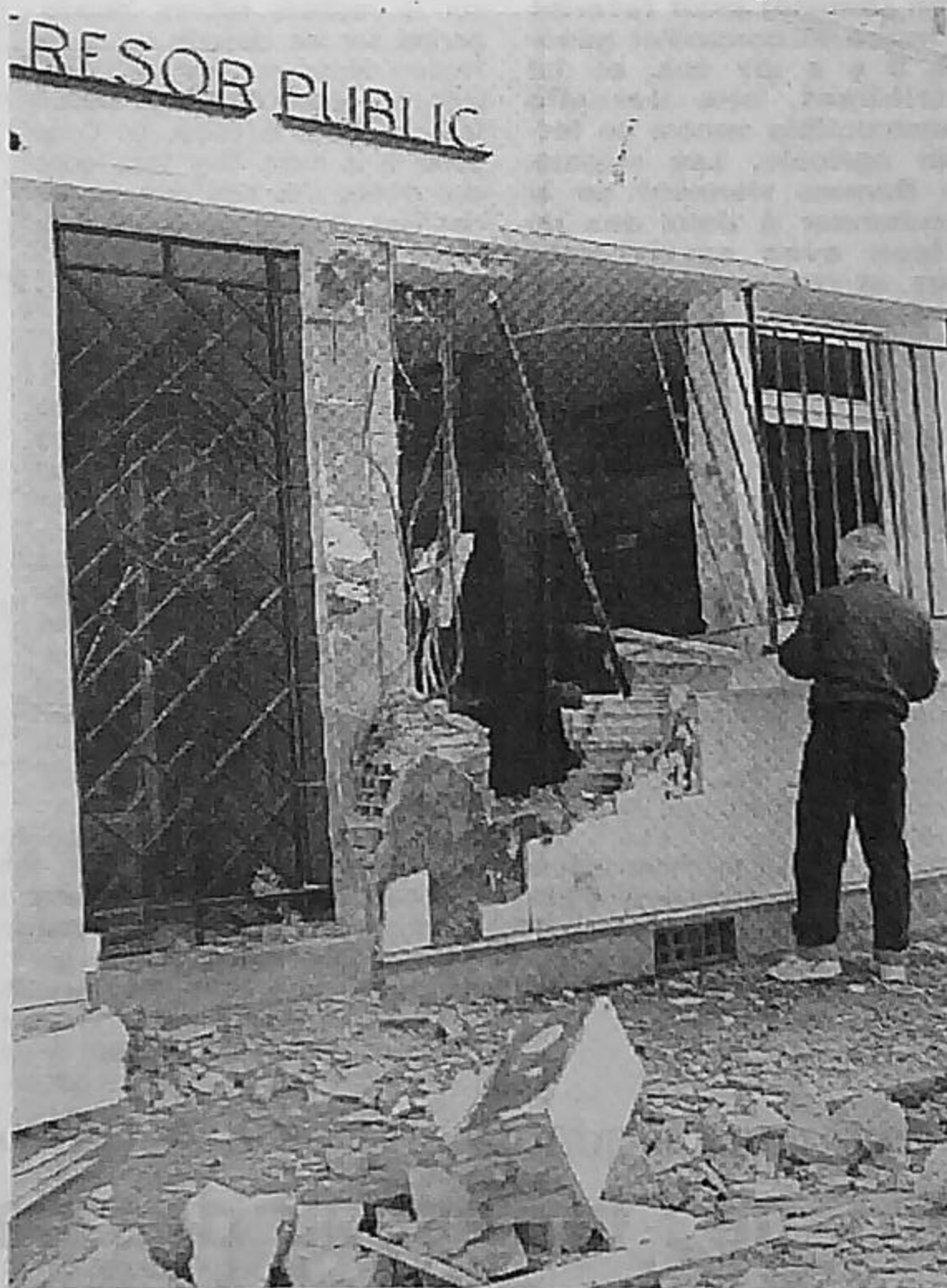
L'explosion a provoqué un trou de plus d'un mètre de diamètre dans le bâtiment de la perception. Toutes les vitres ont été brisées et leur grille de protection arrachée.
