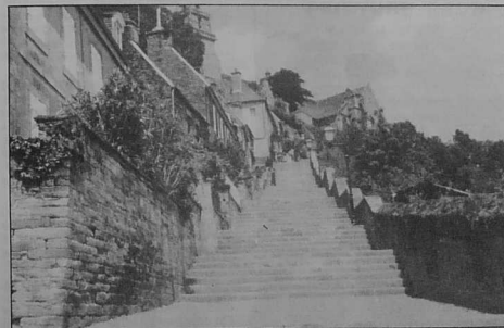
Les escaliers après travaux : tous les paliers ont été refaits, les marches rejointoyées ; le granit a retrouvé toute sa noblesse.
