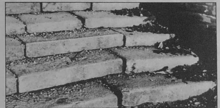
Les escaliers de Brélénévez avant les travaux : pierres disjointes, affaissées, sol inégal...
