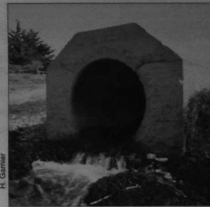
Un exemple frappant de rejet pluvial situé sur la plage de la Tara. D'après les analyses de la DDASS, ce rejet est régulièrement contaminé par des bactéries pathogènes.
