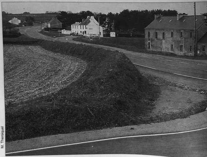
A Locmaria-Plouzané (Finistère) un talus nouveau construit à l'engin par les services départementaux lors d'un réaménagement routier en 1991.
