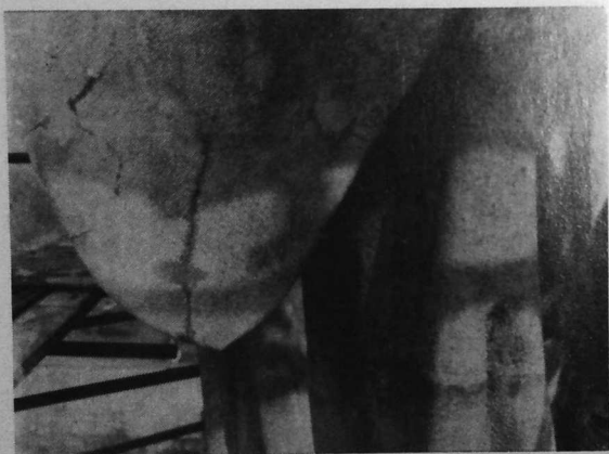
...Et des fissures (Le Pèlerin, n° 270, cliché page 18)
