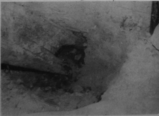
« Le mortier a conservé l'humidité qui a accéléré la détérioration » (Le Pèlerin, n° 268, page 26)
