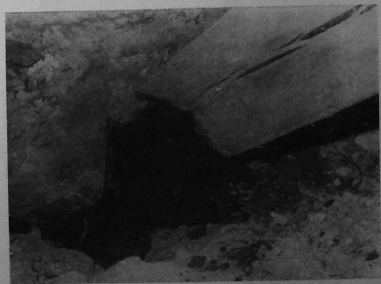
« L'extrémité des poutres est complètement pourrie... »
