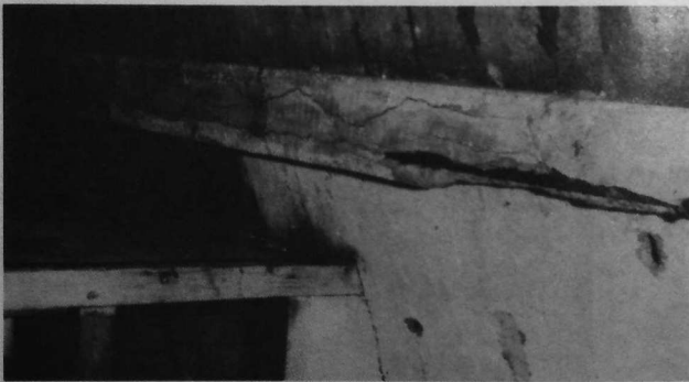
Les poutres de béton étaient éclatées (Pèlerin n° 263, cliché page 32)
