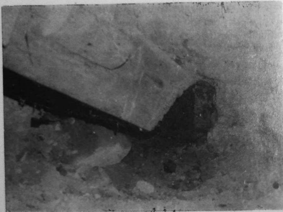
« Certaines poutres ne prennent appui, dans le mur, que par de très courts centimètres » (Le Pèlerin, n° 268, page 23)
