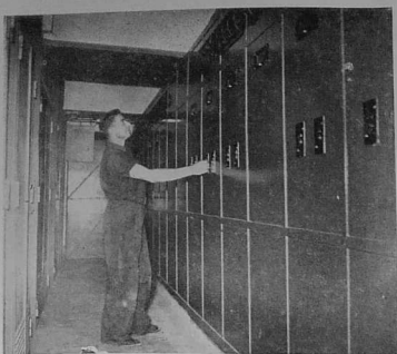
Le couloir de manœuvre basse-tension
