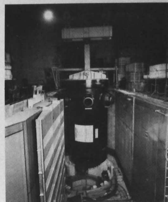
mise en place de la cuve du réacteur de la centrale du Bugey II
