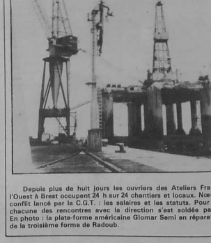
Depuis plus de huit jours les ouvriers des Ateliers Français de l'Ouest à Brest occupent 24 h sur 24 chantiers et locaux. Neud de ce conflit lancé par la C.G.T. : les salaires et les statuts. Pour l'instant chacune des rencontres avec la direction s'est soldée par échec. En photo : la plate-forme américaine Glomar Semi en réparation près de la troisième forme de Radoub.
