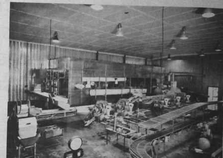
Vue intérieure d'un tunnel de congélation avec fluideur et atelier de conditionnement (installation C.E.G.F.).
