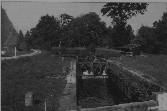
Meules de paille de l'éclusière à Saint-Médard vers 1960 ; à droite, le lavoir public. On remarque un certain abandon de l'entretien : herbes entre les pierres, fuites d'eau à la porte amont, bois non protégé...
