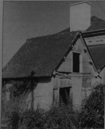
L'ancien bureau du conducteur de la brigade de BAZOUGES-SOUS-HÉDÉ, attenant à la maison d'écluse de "La Madeleine", est toujours debout mais en très mauvais état.
