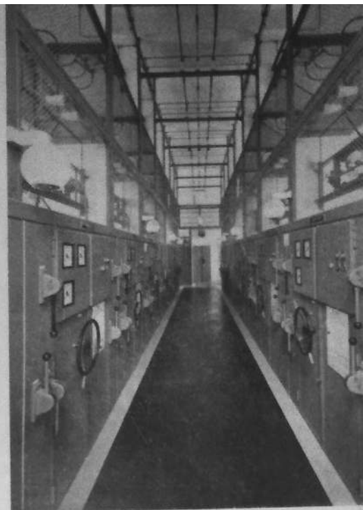
VUE INTERIEURE DU POSTE 15 kV DE PAIMPOL
