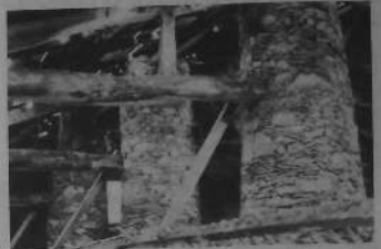
Grange-étable à La Chapelle Hermès, Haut-dit du Pré. Toiture plate à double pente supportée par 10 piliers ronds en moellons. Le bâtiment est condamné suite à inondation en hiver.
