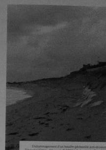
Endommagement d'un boudoir géologique anti-érosion à Trégouet (Côtes-d'Armor). © CEREMA, Sylvain Le Stop, 2021.
