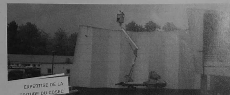
EXPERTISE DE LA TOITURE DU COSEC
