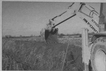
Talus construit en 1994 au tracto-pelle. Mettre les mottes enherbées sur le bord et la terre noire au milieu.
